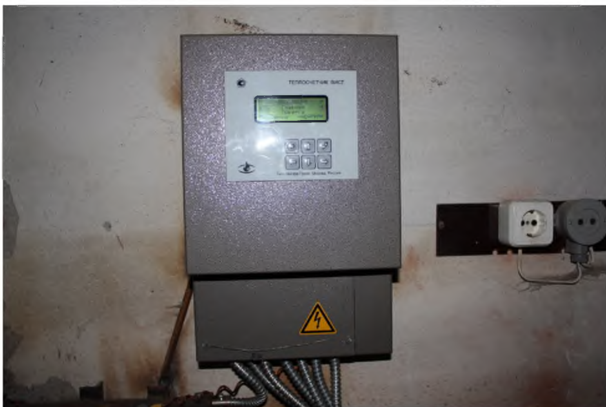
Фото 3.10 Счетчик узла учета системы теплоснабжения
