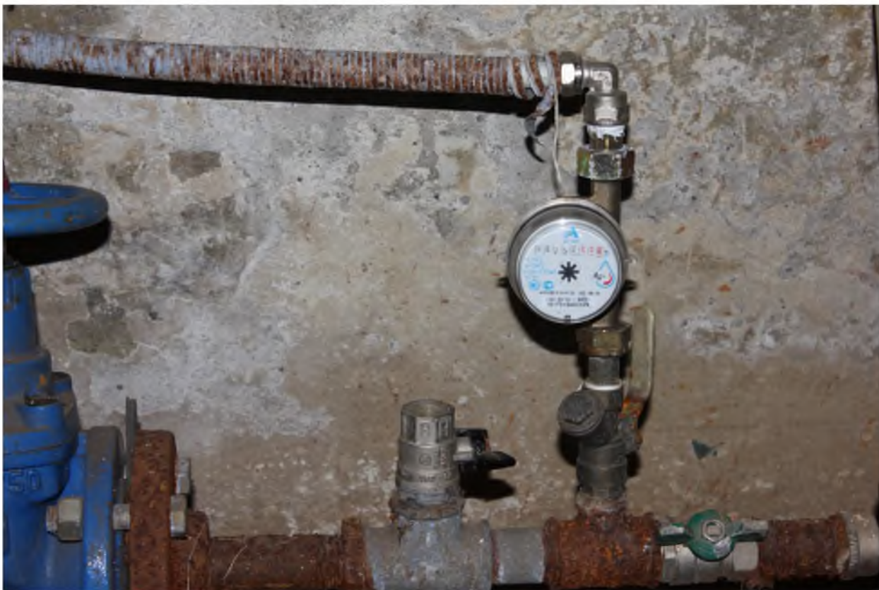
Фото 4.2 Состояние узла учета водоснабжения
