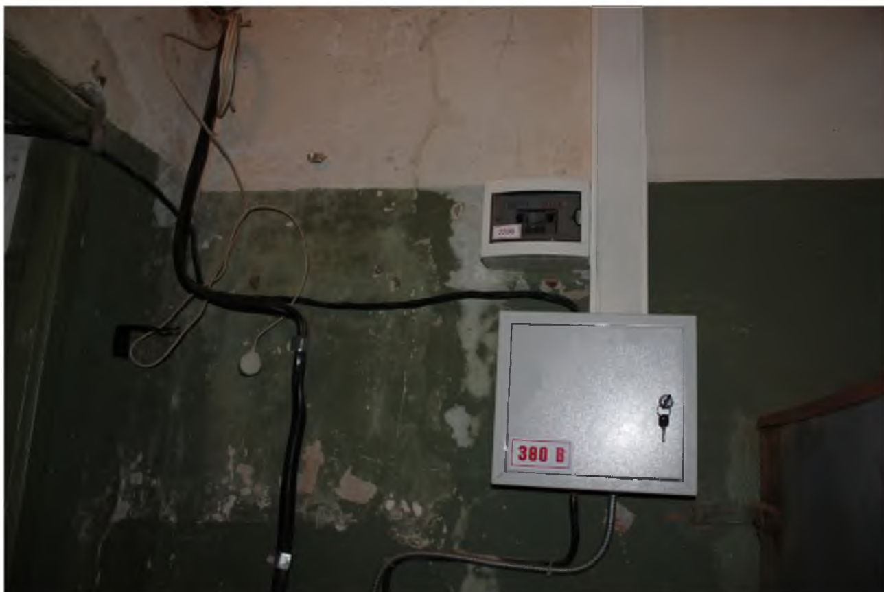
Фото 2.9 Шины подачи электроэнергии потребителям
