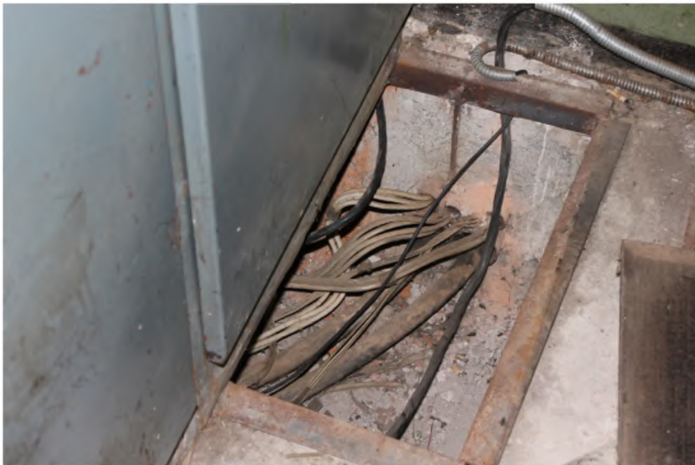
Фото 2.7 Вводные шины подачи электроэнергии в здание
