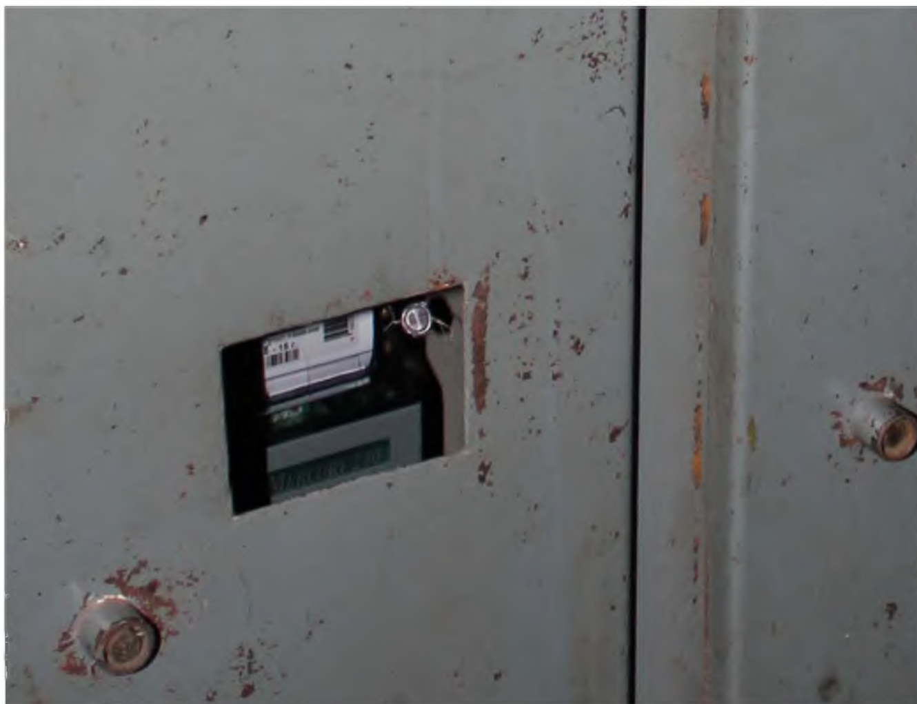
Фото 2.10 Узел учета электроэнергии
