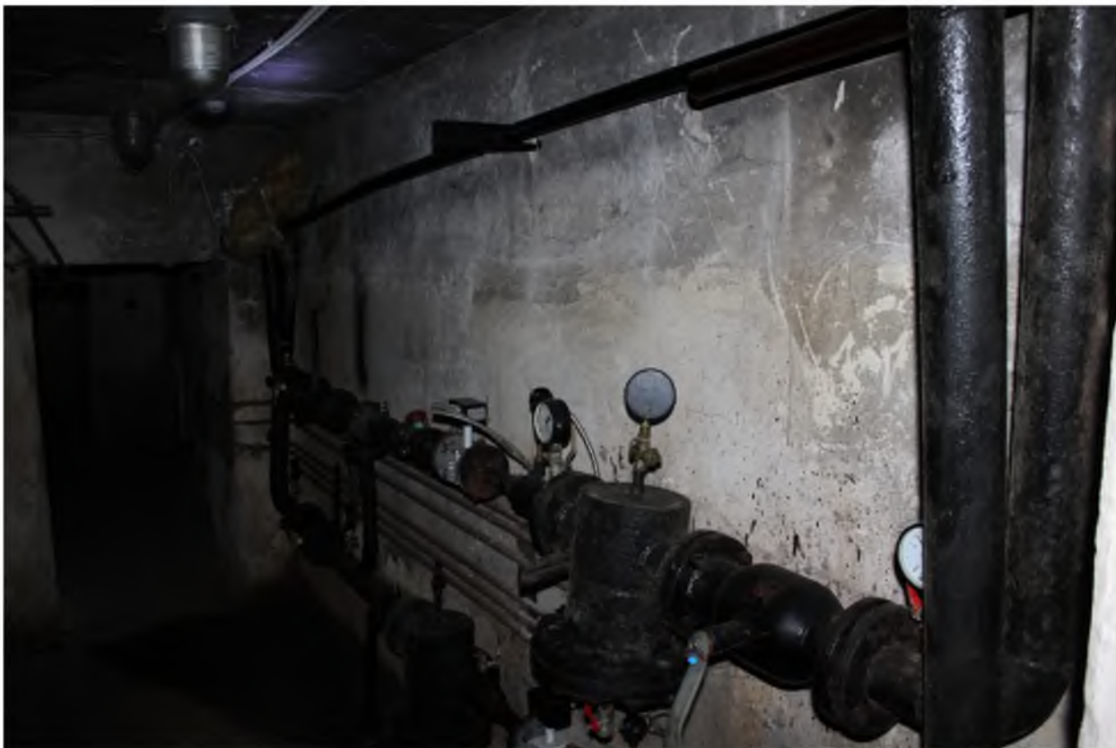
Фото 3.3 Общий вид теплового пункта
