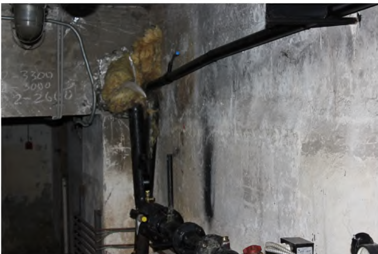
Фото 3.4 Вход труб теплоснабжения в тепловой пункт
