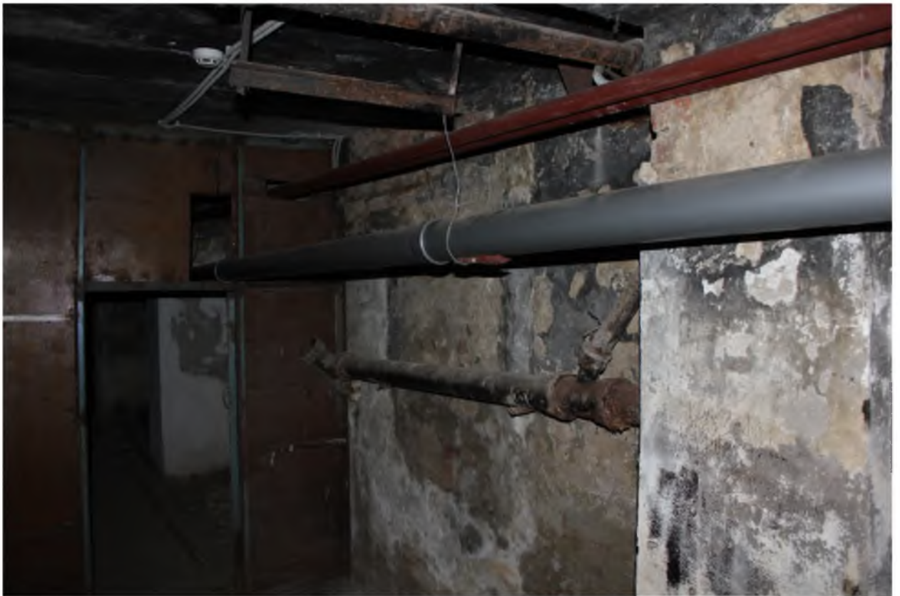
Фото 4.7 Трубы водоотведения. Канализация и водосток
