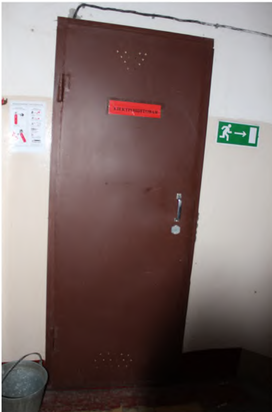
Фото 2.1 Входная дверь в электрощитовую
