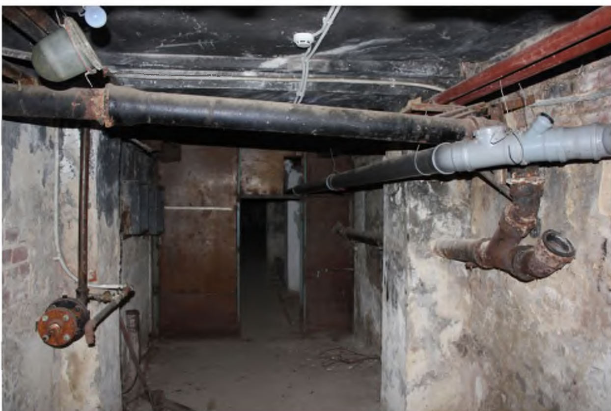
Фото 4.6 Общий вид инженерных коммуникаций в подвале
