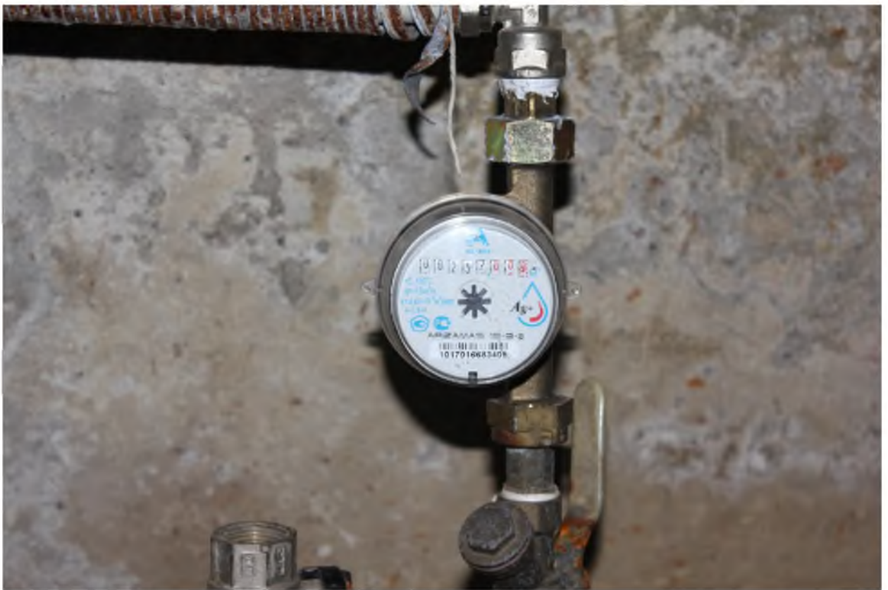
Фото 4.3 Счетчик узла учета водоснабжения
