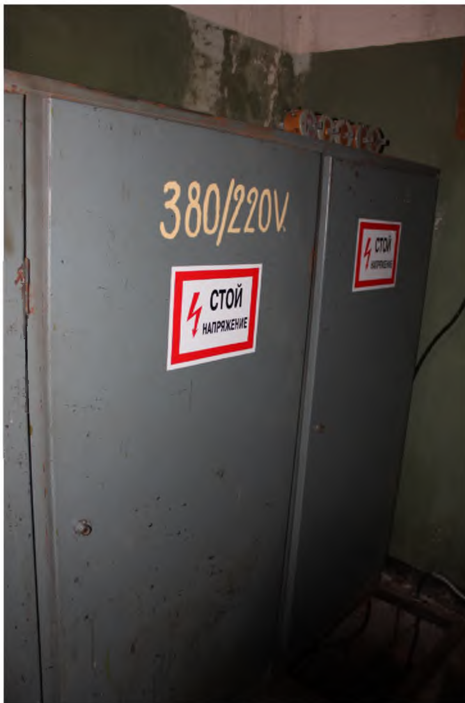
Фото 2.4 Шкафы ввода электроэнергии
