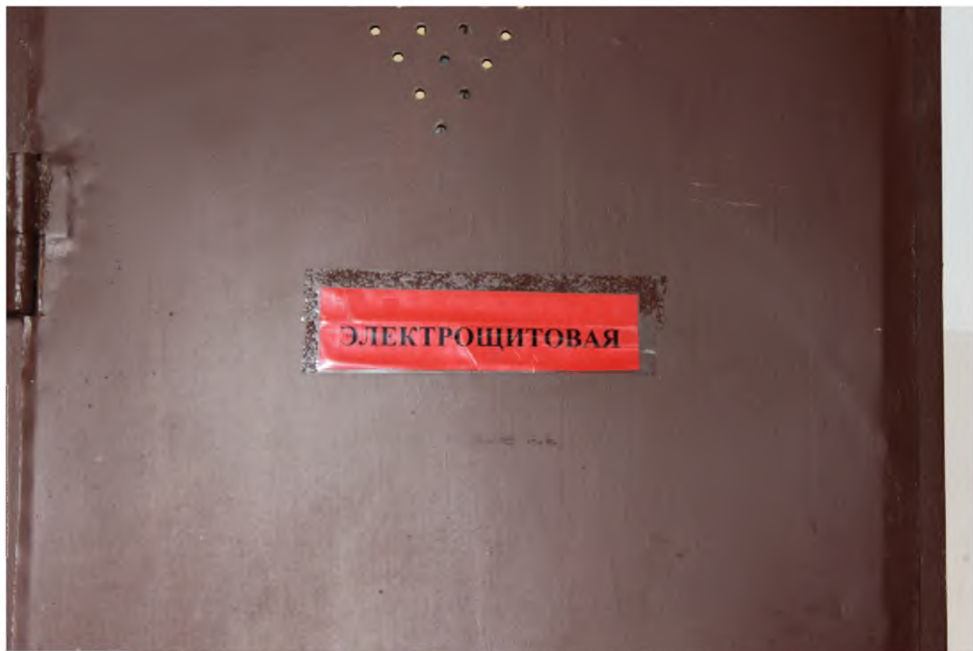
Фото 2.2 Входная дверь в электрощитовую.
