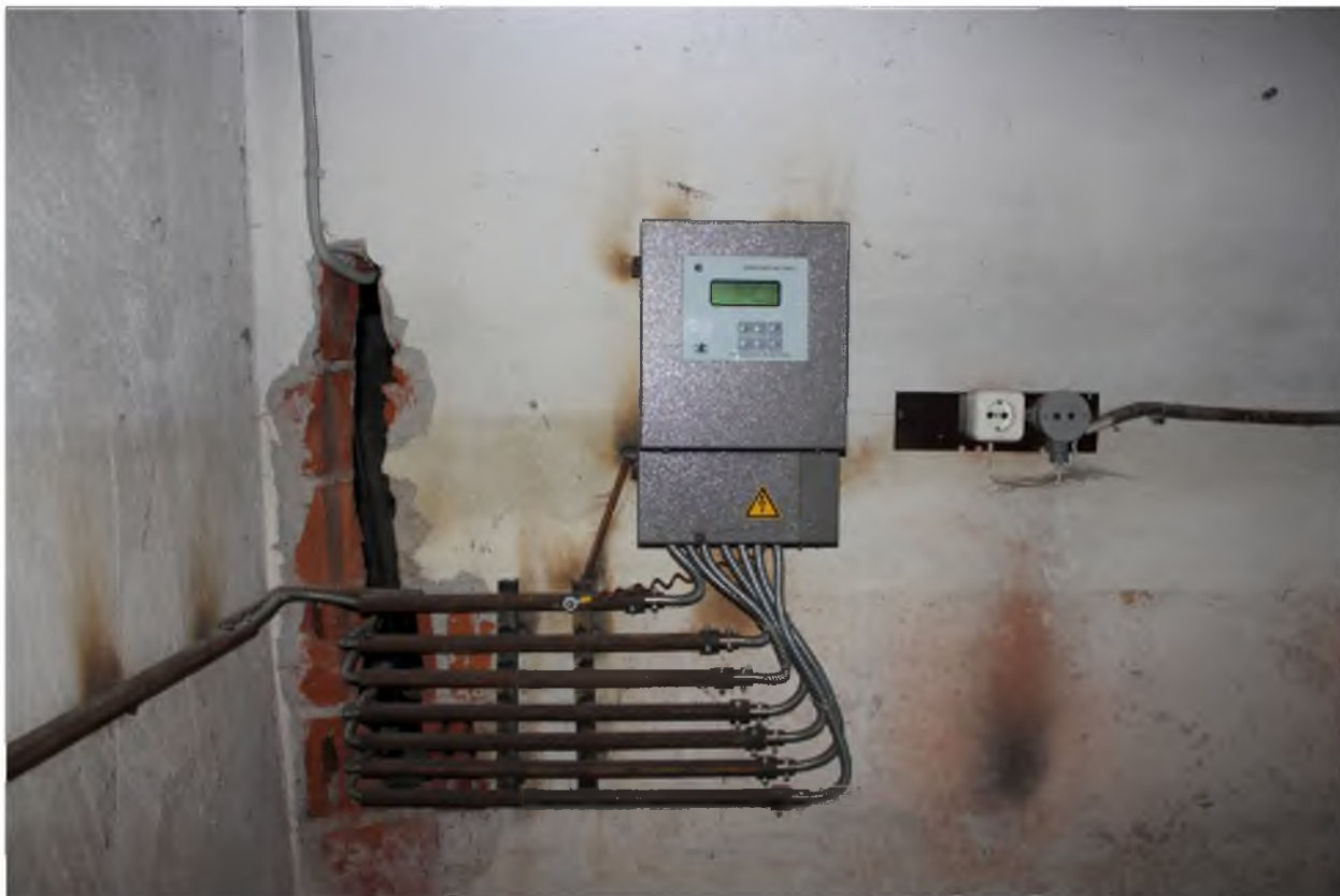
Фото 3.9 Узел учета системы теплоснабжения
