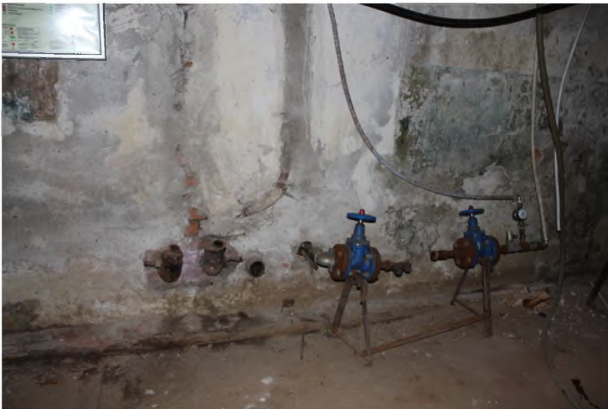
Фото 4. 1 Подача водоснабжения отключена
