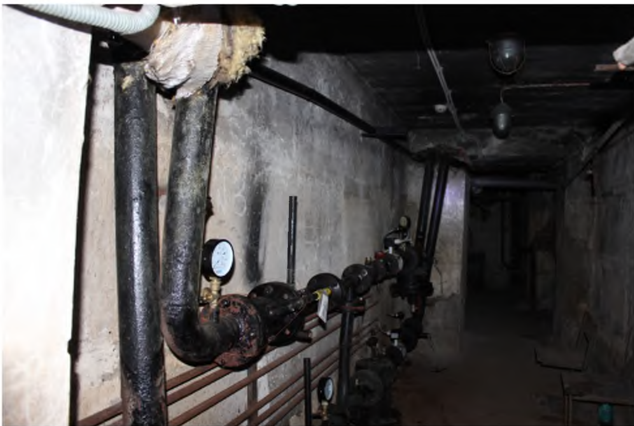
Фото 3.2 Общий вид теплового пункта
