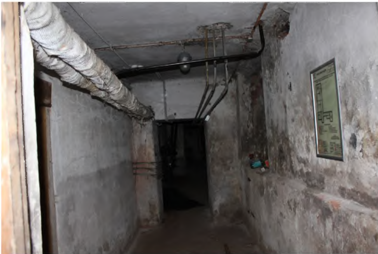
Фото 3.1 Трубы подачи теплоснабжения
